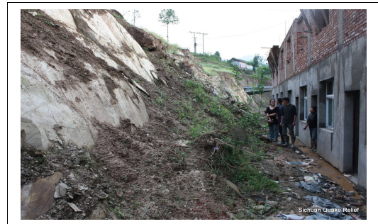
雨水沿着陡峭的、未加固过的斜坡冲下，聚集在尚未完工的房屋混泥土地基和地板下面——四川北部（2010 年 5 月）
